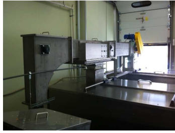
自動搬送システムで 生ごみ処理機へ投入
