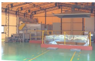
1次発酵エリア全景
