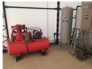
エアコンプレッサー (圧縮空気を製造)
